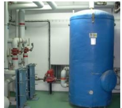
Sous-station eau chaude sanitaire ►
