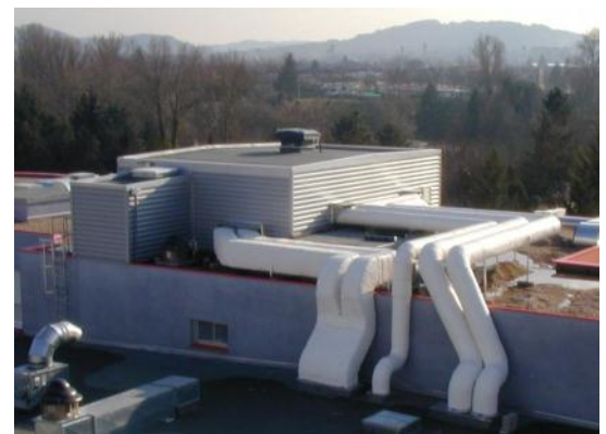
Traitement d'air blocs opératoires ▲
