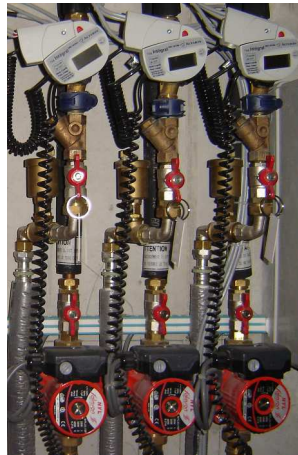
▲ Colonne compteurs chauffage
